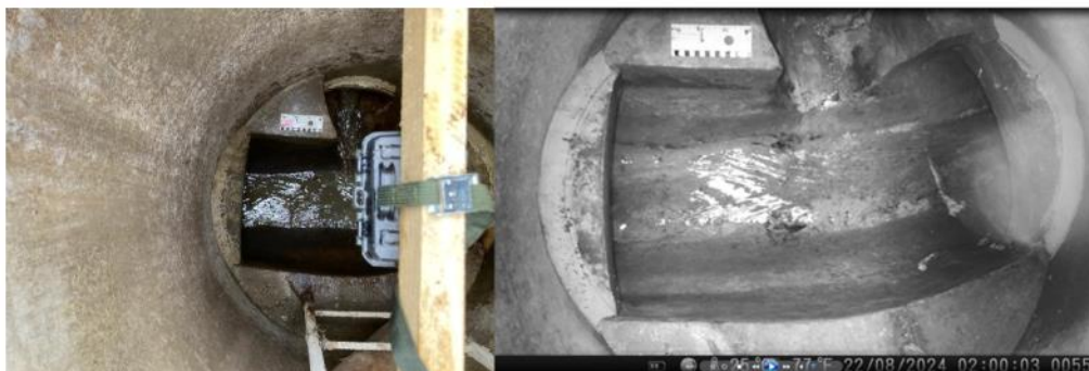
Installation Kamera in Messschacht und Standbild der Kamera zur Auswertung
